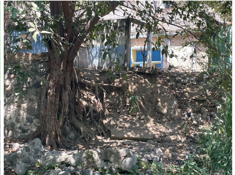
Imagen de Afectación Muro contención en Río – Mayo 2023
